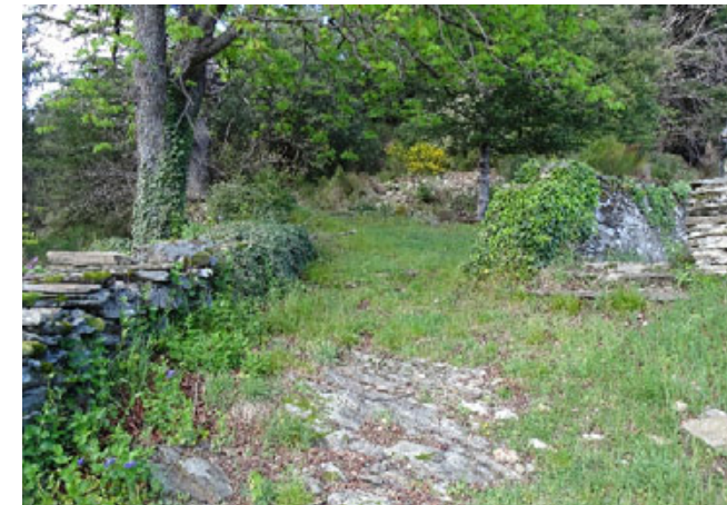
Muret en pierre de schiste dans un état dégradé
